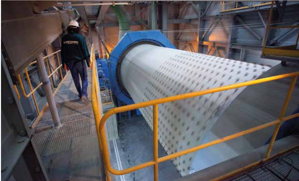
Moara de ciment nr. 4 CEMTEC, vedere dinspre alimentare spre evacuare
